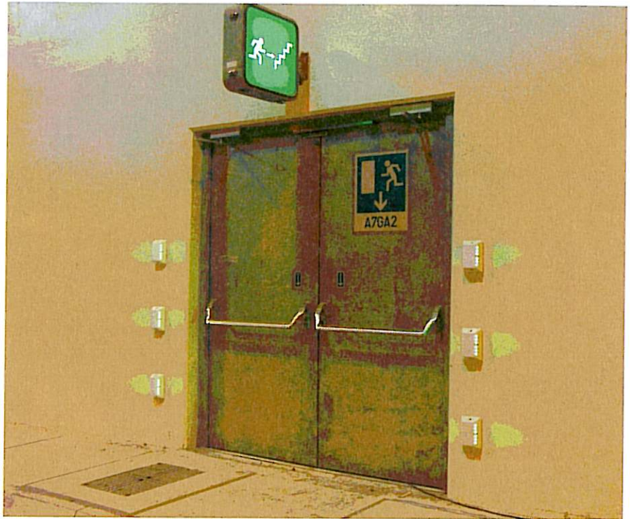
Tunnel Bindermichl Notausgang
