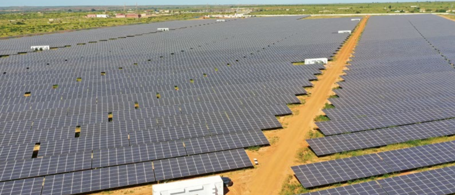
Photovoltaik-Kraftwerk Diass, Senegal, mit 23 MWp
