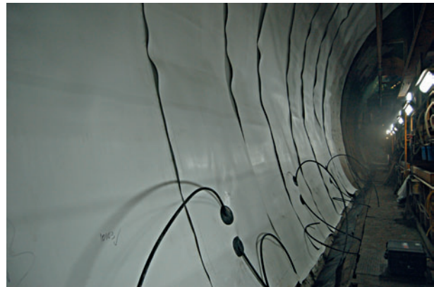
6 Abdichtungsfolie mit Injektionsanschlüssen während des Einbaus Waterproofing membrane with grouting hoses during assembly
