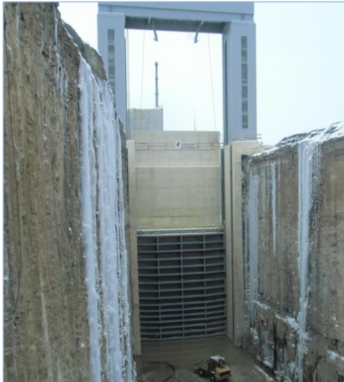
Abbildung 4-1: Auslaufbauwerk mit Tafelschütz vor dem Fluten
