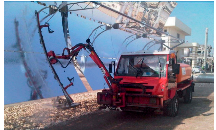
Abb. 3.1.2.2: Reinigung der Parabolrinnen des solarthermischen Kraftwerks Kuraymat, Ägypten | Quelle: Gerhard Hofmann, Agentur Zukunft
