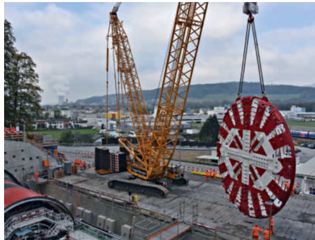
11 Aufbau TBM beim Tunnelportal Ost (Wöschnau) Assembly of TBM at east tunnel portal (Wöschnau)
