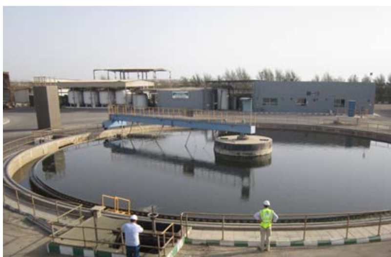
Industriekläranlage in Jeddah Industrial City, Saudi-Arabien
